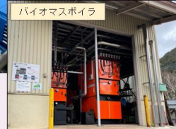
バイオマスボイラ
