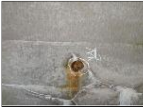
修復モルタルの落下
