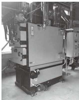
▲チップボイラー
