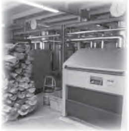
設置済みの黄金泉薪ボイラー
