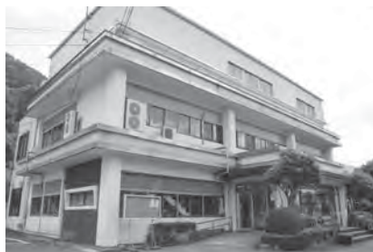
↑現在の役場本庁舎。耐震診断で倒壊の危険性が指摘されています。
