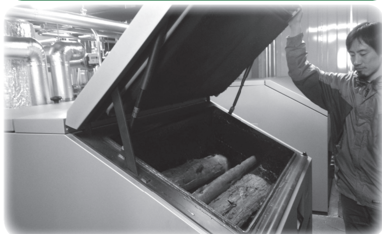
▲黄金泉に設置された薪を燃料にしたバイオマスボイラー 1日4～5回人力で薪を投入
