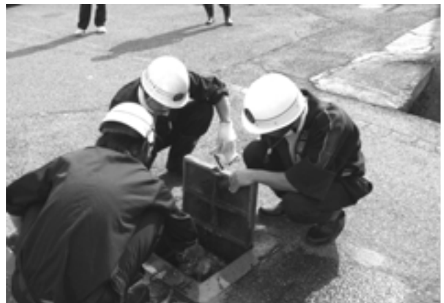
中土居地区の消火栓点検の様相
