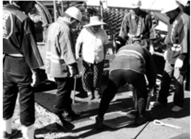
下土居地区の消火栓点検の様相
