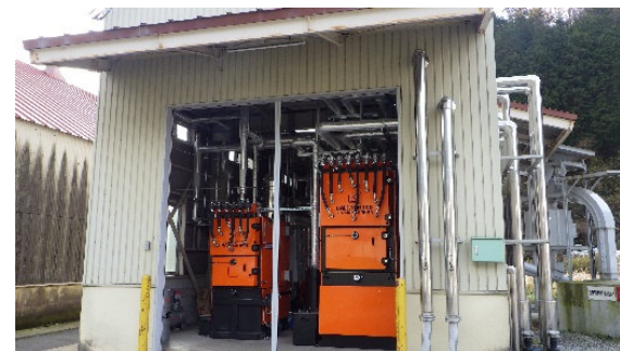
木質バイオマス発電（地域熱供給システム）
