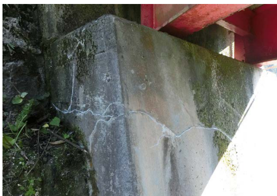
岡本橋（下部工 ひび割れ）
