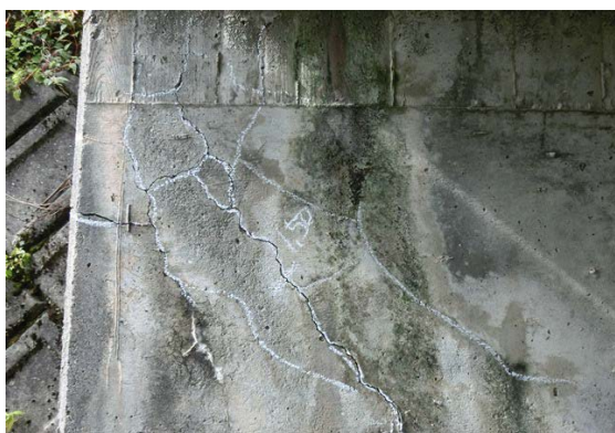
四行田橋（下部工 ひび割れ）
