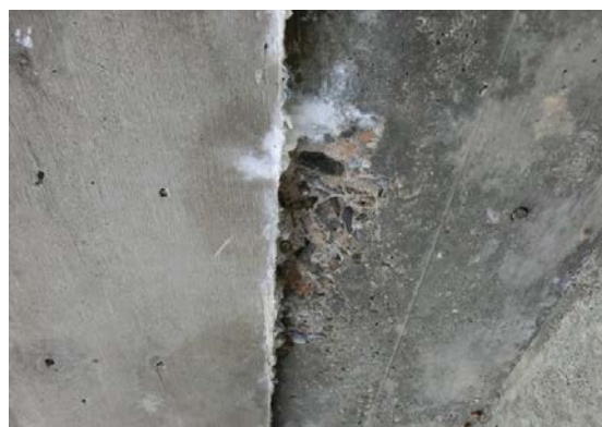
ヲ才田橋（床版 剥離、遊離石灰）
