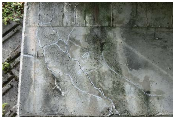
下部工のひび割れ
