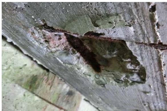
横桁の剥離を伴う鉄筋露出
