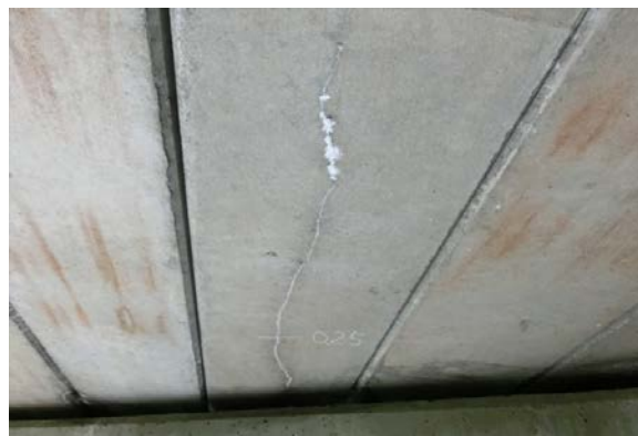
主桁のひび割れ
