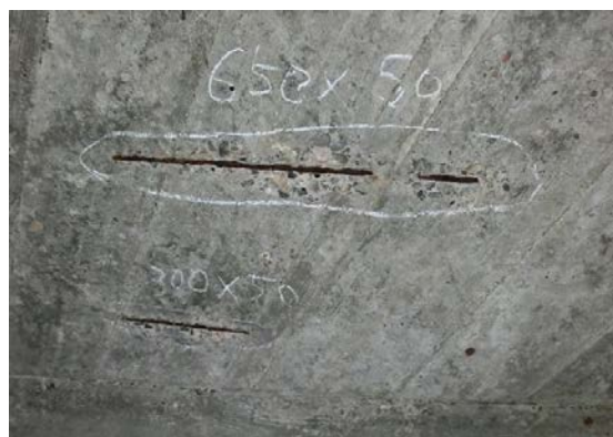
ヲ才田橋（床版 鉄筋露出）
