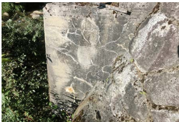
下部工のひび割れ
