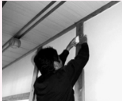
《住宅用火災警報器設置状況》
